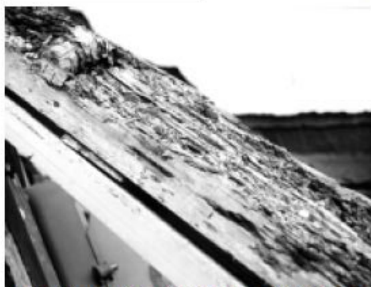
蟻害にあった構造材。ボロボロに食われ家を支えられるだけの強度が失われている。
